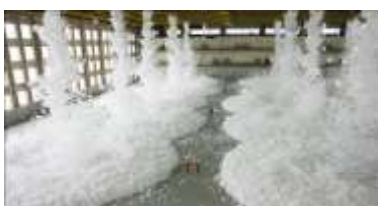
Рисунок 4 - Спринклерная установка пожаротушения
