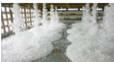
Рисунок 4 - Спринклерная установка пожаротушения
